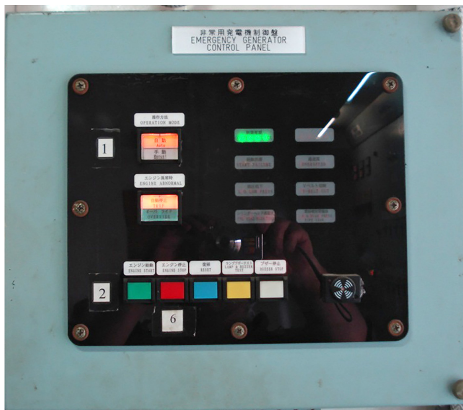
Рис. 6. Панель управління АДГ. (EMERGENCY GENERATOR CONTROL PANEL)
