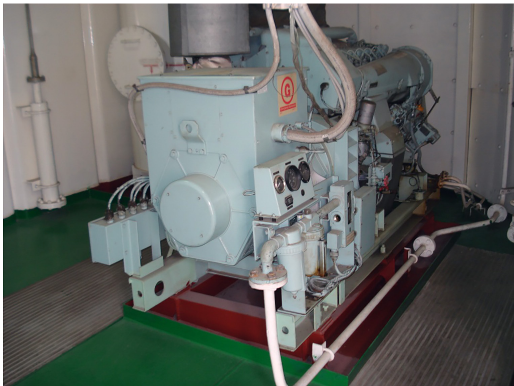
Рис. 2. Аварійний дизель-генератор (АДГ) (EMERGENCY DIESEL- GENERATOR/EDG)
