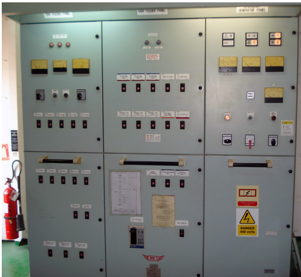
Рис. 3. Загальний вигляд аварійного розподільного щита (АРЩ)
