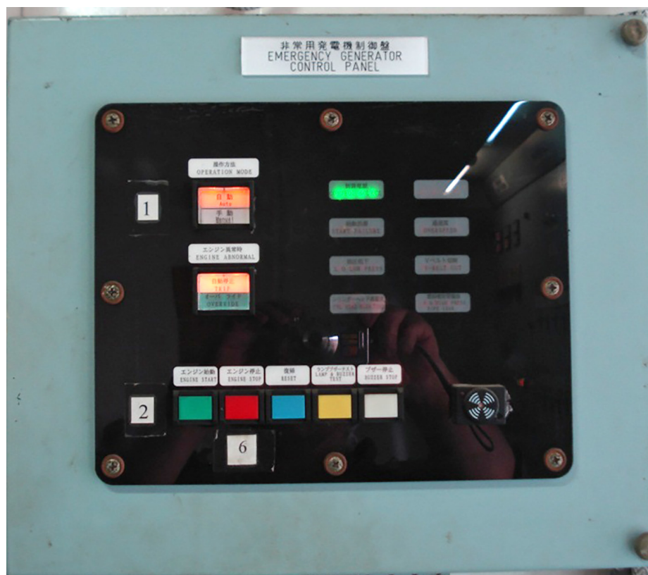
Рис. 6. Панель управління АДГ. (EMERGENCY GENERATOR CONTROL PANEL)
